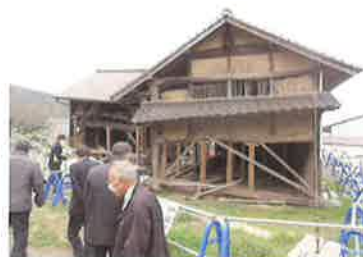
熊本県益城町の被災家屋
