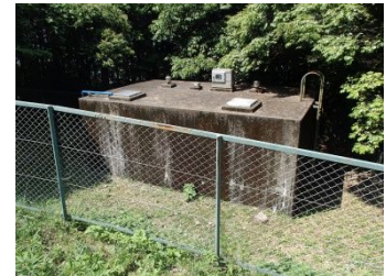
平似田高区配水池
