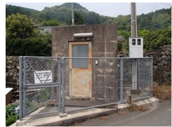
中川内加圧ポンプ所
