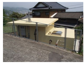
音琴中継ポンプ場
