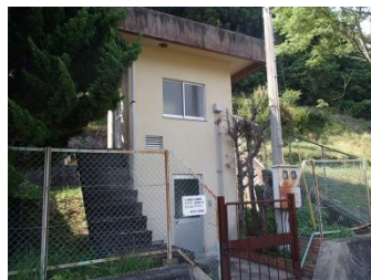
坂本浄水場・中継ポンプ所
