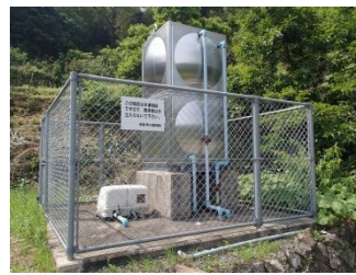
音琴地区加圧ポンプ所
